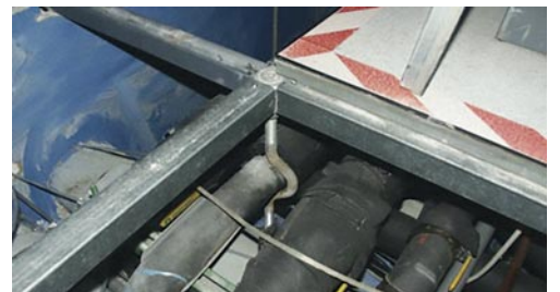
Vérins déformés par le prestataire qui a fait passer les fluides où poser le plancher... inefficace et dangereux, compromet fortement l'équilibre de l'ensemble. (découvert lors d'une expertise)
