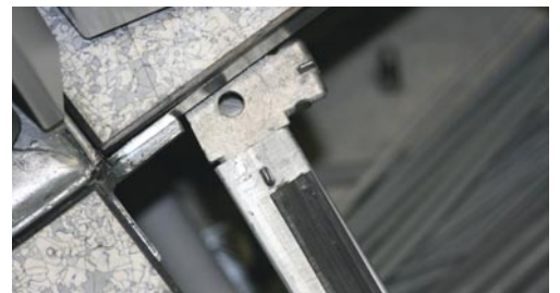
Tête de vérin décalée à la limite de la rupture
