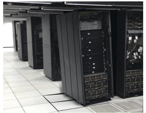
Début d'effondrement d'une baie, il faut agir pour la mise en sécurité et déterminer la cause.
